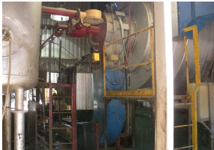
Ilustración No. 35 Centro de control del quemador del secador rotativo
