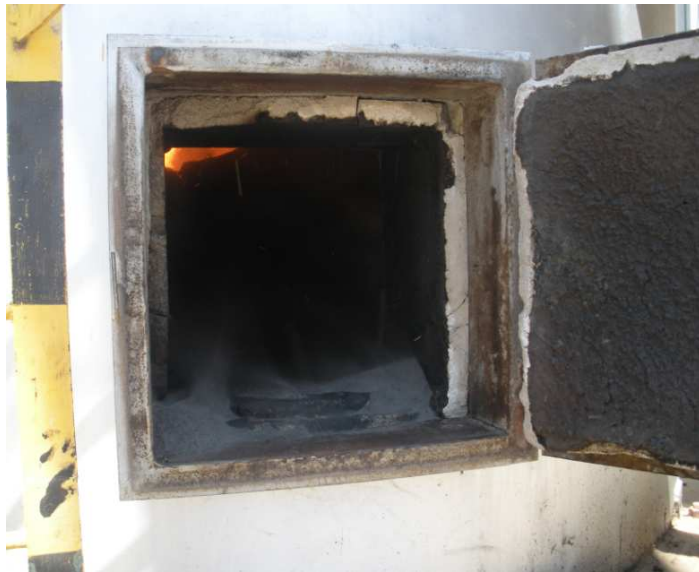
Ilustración No. 5 Quemador que utiliza el aserrín fino como combustible
