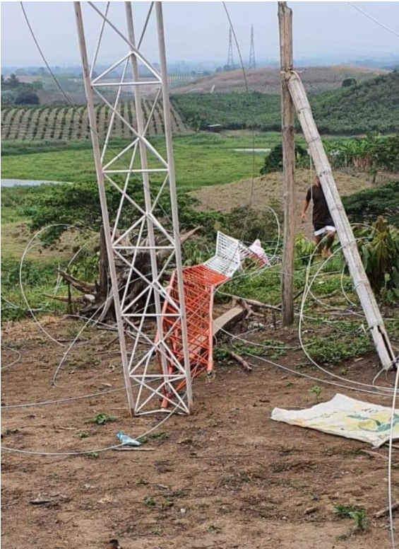
Torres Dañadas debido a una tormenta tropical.
