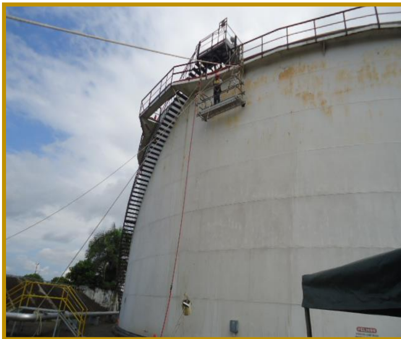
Ilustración 14 rasquetado manual a las corrosiones del techo fijo en el tanque, anillo de viento y gradas.
