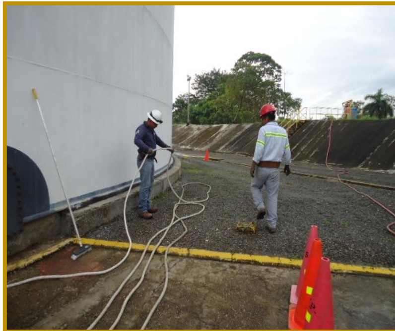
Ilustración 8 Subir al anillo de viento a instalar lazos y líneas de vida
